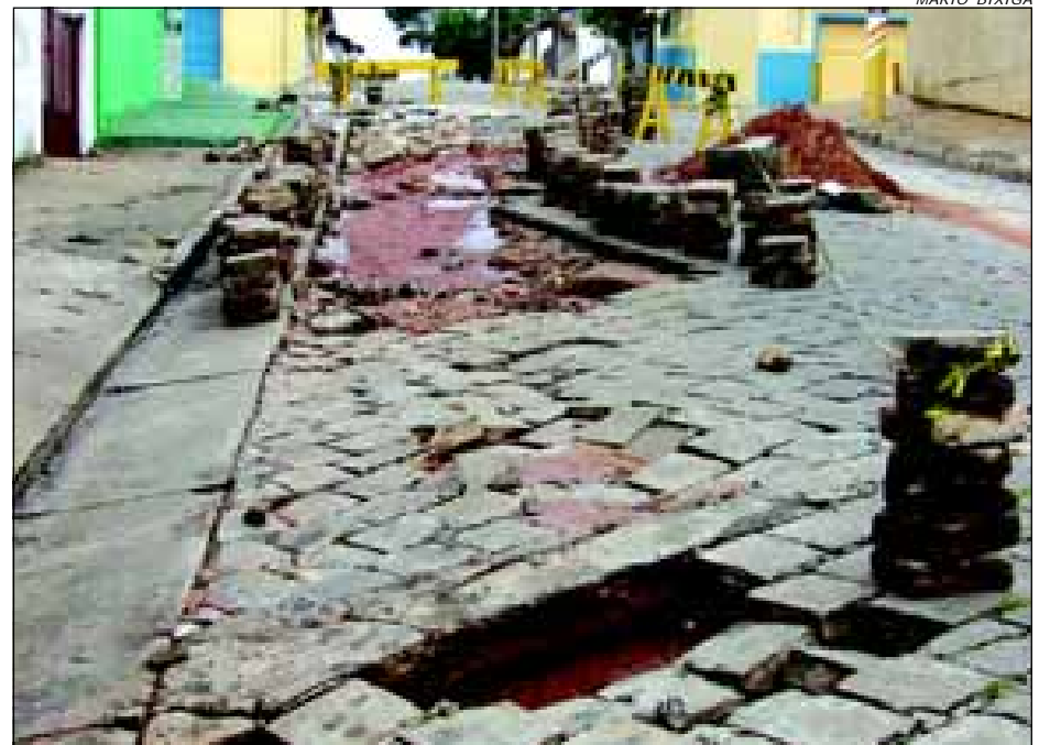
Chuvas causaram muitos estragos
