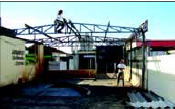
Imóvel da Rua Distrito Federal em demolição, em frente ao antigo Posto de Gasolina
