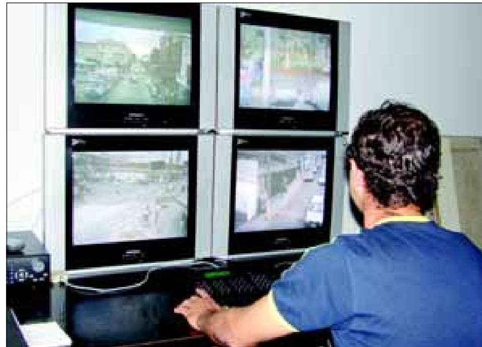
Central de Monitoramento
