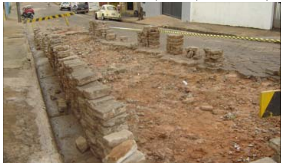
Na Rua Acre as águas da chuva levaram parte das lajotas
