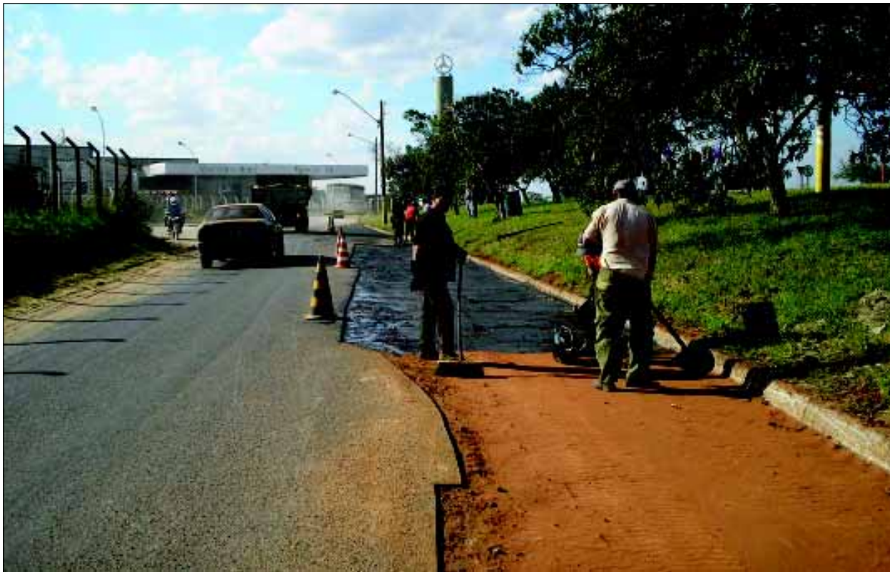
Avenida estava bastante danificada
