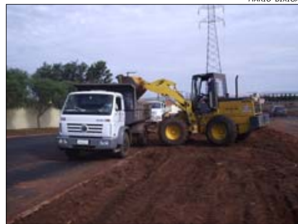
Está sendo feito o trabalho de terraplanagem para posteriormente iniciar o plantio de grama
